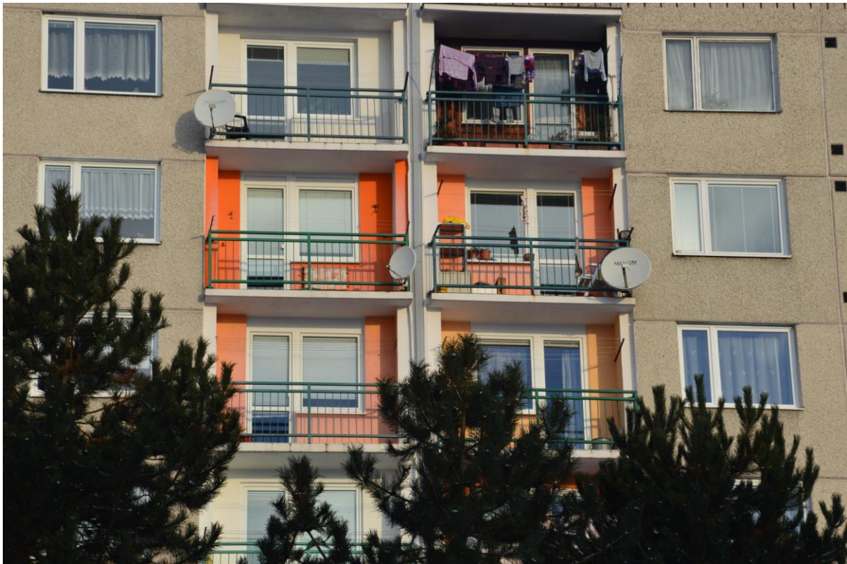
Snímek č. 9 – č.p. 1313 - 14 – zadní strana 4. – 5. NP – dilatace
